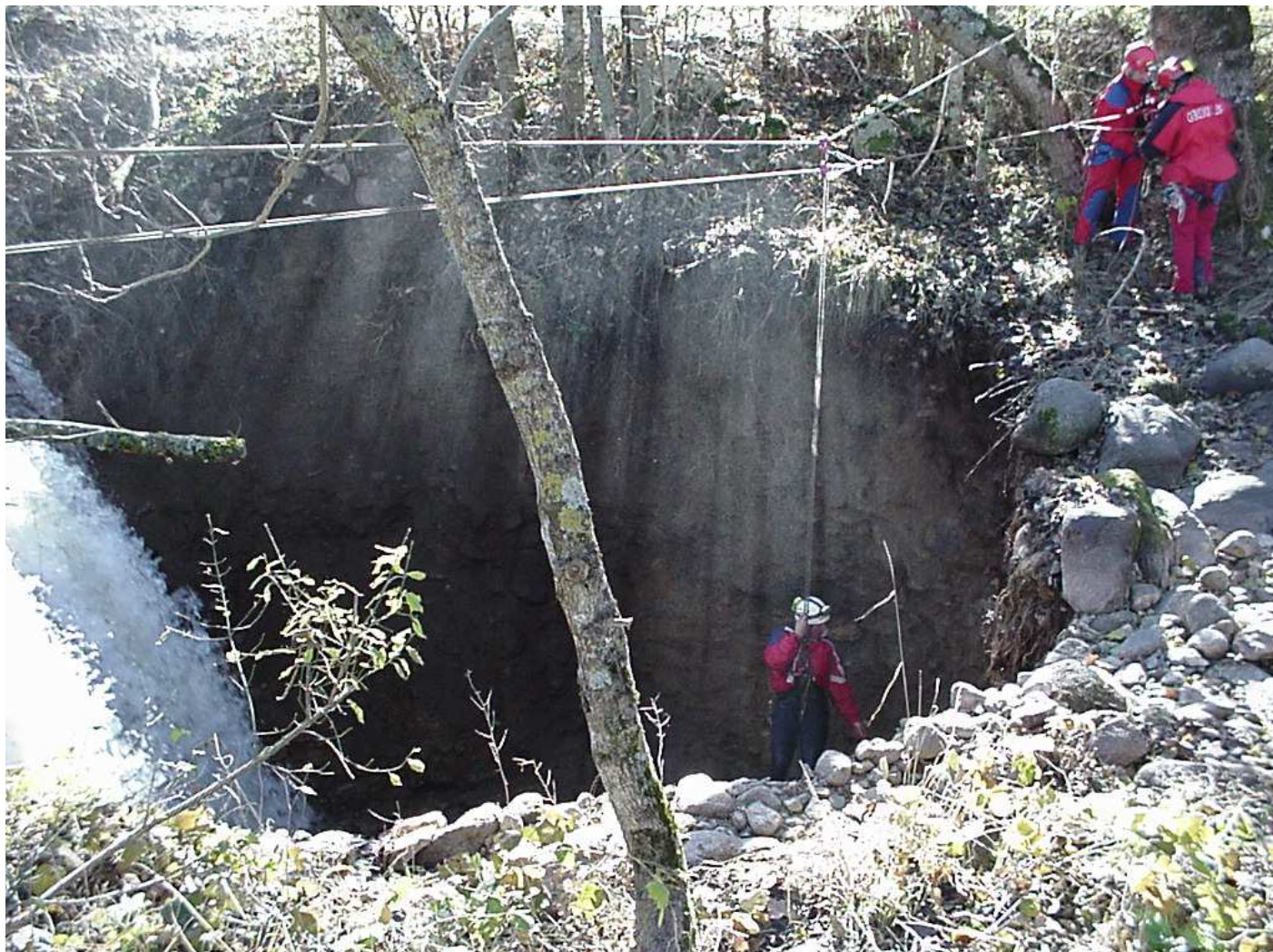
Illustration 5: Effondrement sur le lit du Bramont, sur la commune de Saint-Etienne du Valdonnez (novembre 2003) [Photo DDT 48]
