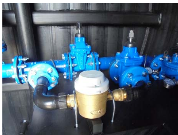
PEHD 63 avec vanne et compteur pour limiter le débit à 3l/s
