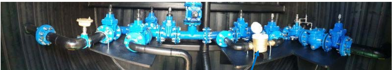
Le PEHD 63 avec vanne de réglage et compteur de mesure
