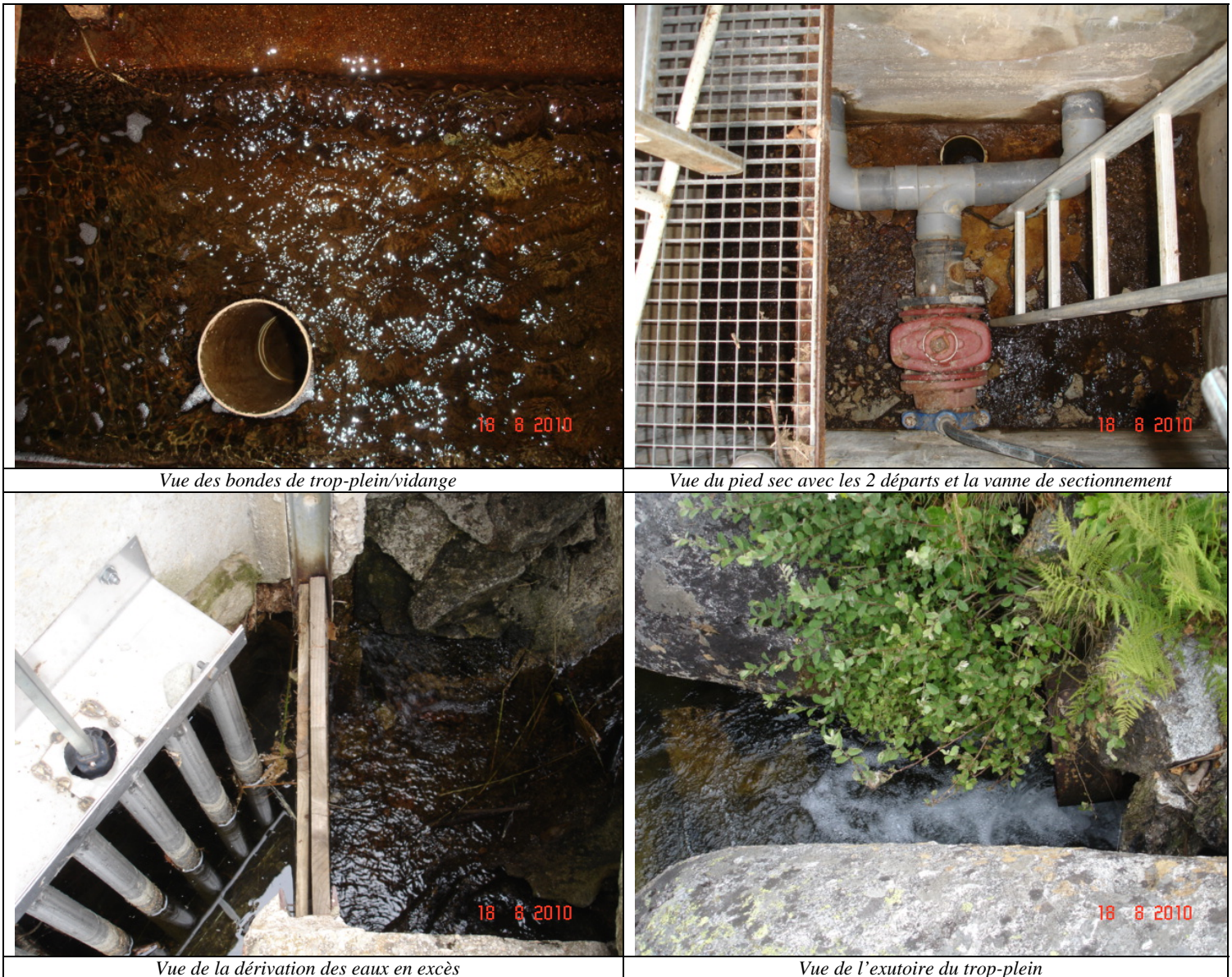
Figure 2 : Photos de la prise d'eau de Caguefer du 18 Août 2010
