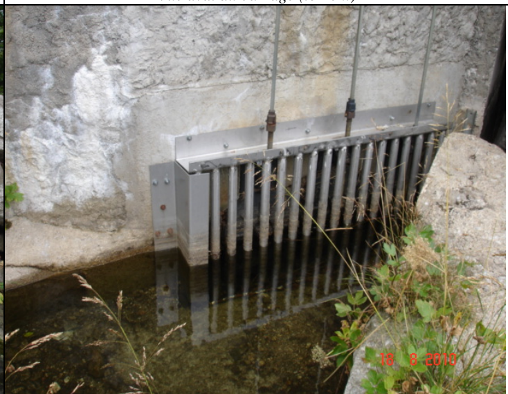
Vue du barreaudage de protection en entrée de la prise d'eau
