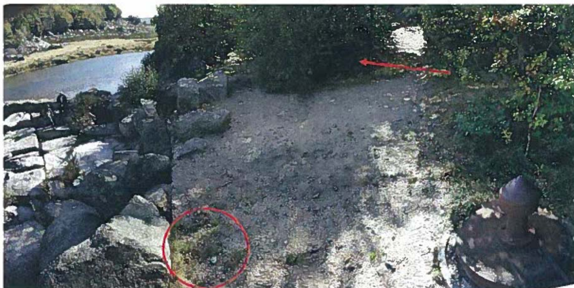
Photo 9 : Vue générale du captage depuis le sommet (à gauche défauts d'étanchéité, à droite sens du ruissellement vers l'amont du captage)
