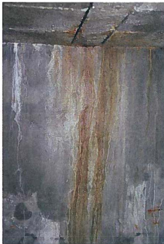
Photo 12 : Infiltration dans l'ouvrage
