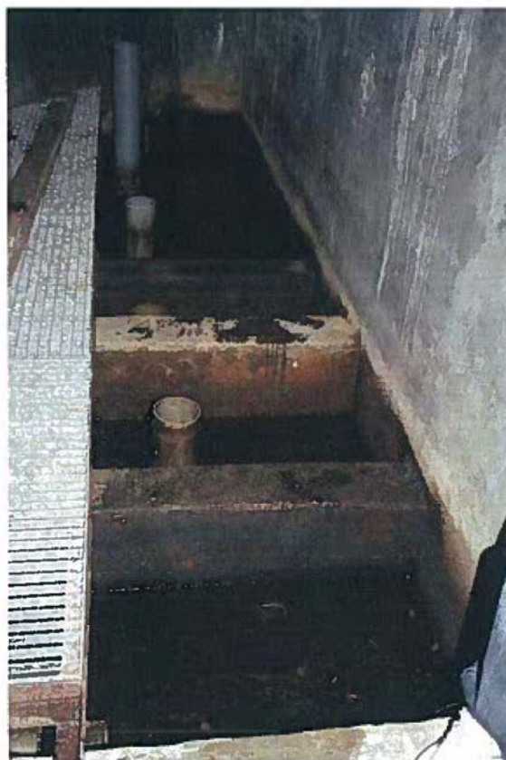
Photo 8 : Série de bacs de décantation
