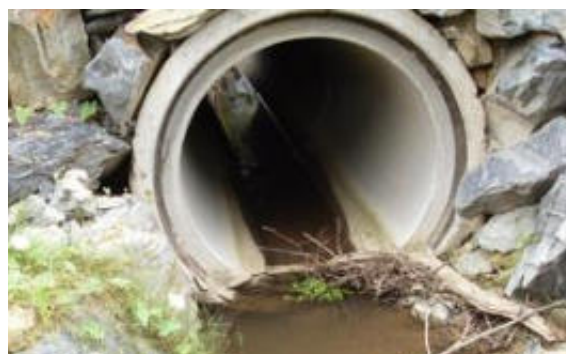
Exemple d'implantation incorrecte d'une buse
