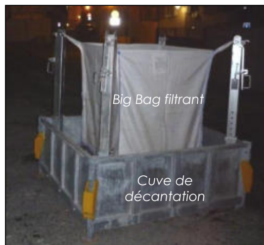
Poste de récupération de laitance de béton Source : Artifex 2017
