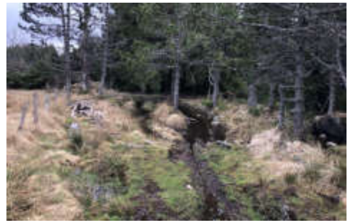
Aménagement à mettre en sécurité (au nord du Peyre Plantade - forêt de la Villedieu)
