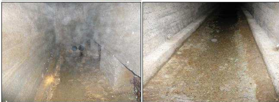
Illustration 12 : Photographies descriptives du fonctionnement et des ouvrages du captage de Channac amont (source : SDAEP, Cereg Ingénierie, 2008)
