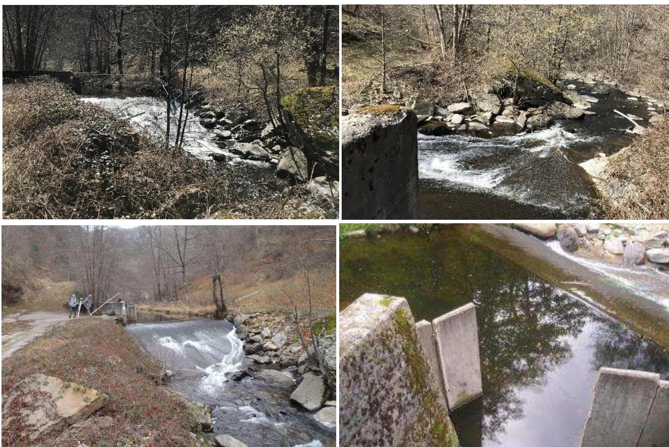
Illustration 4 : Photographies de la prise d'eau actuelle sur la Colagne (source : Cereg Ingénierie, 2015)
