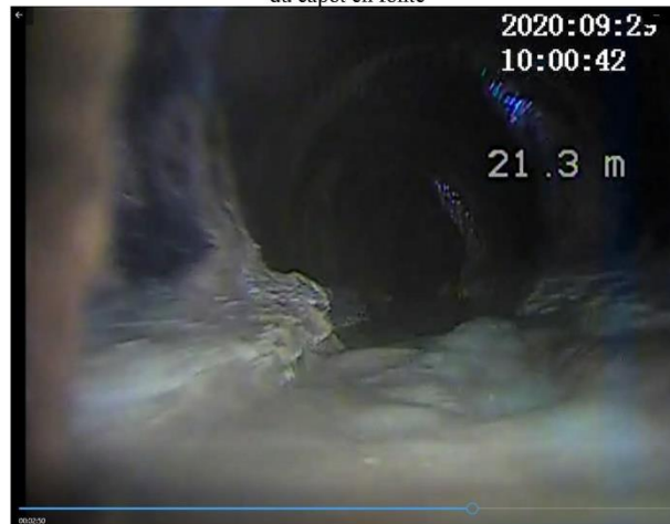
Planche photographique n°5 : Zone de dépôt dans la canalisation
