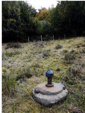
Planche photographique n°4 : vue de la tête de la buse de la chambre de captage et des défauts d'étanchéité de jonction du capot en fonte
