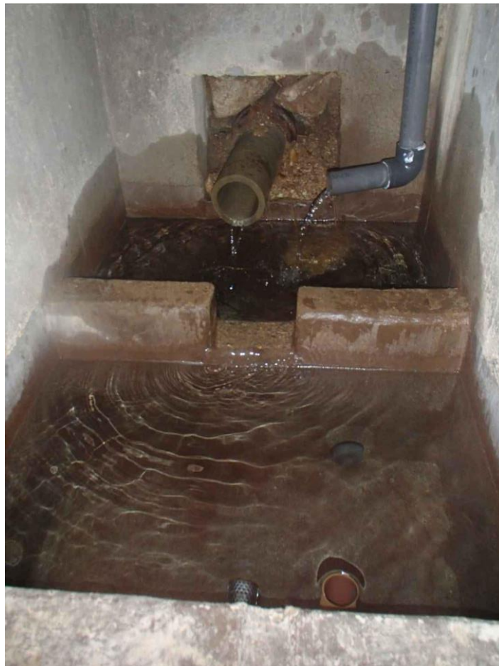
Figure 50 : Photo du bac de décantation du regard aval du captage de VARENNES
