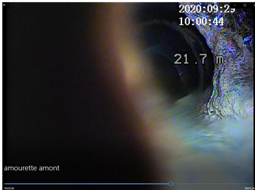
Planche photographique n°6 : Zone de dépôt et possible roche (canalisation cassée ?)
