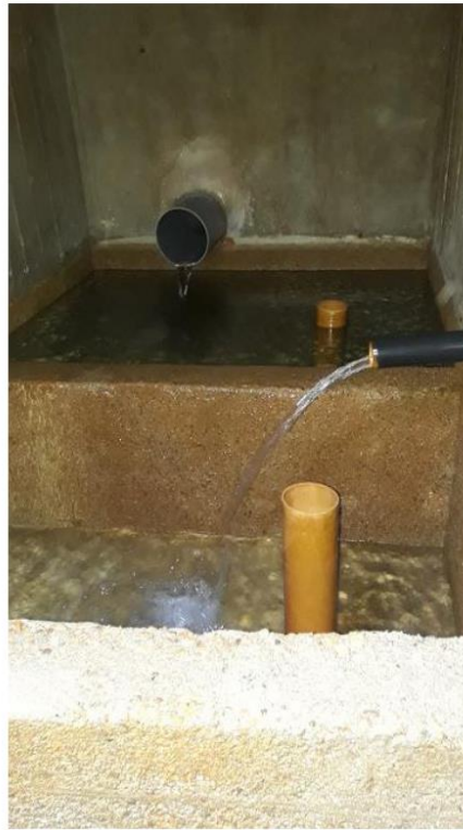
Planche photographique n°3 : vue des bacs de prise et de décantation du captage « Amourettes Aval »
