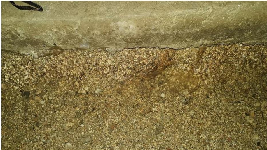
Figure n°4 : granite fissuré et légèrement altéré dans la galerie drainante du captage « Varennes »
