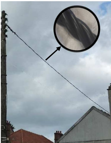
Réseau fils isolés aérien BT
