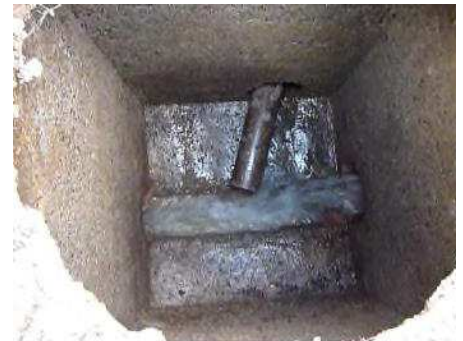
Intrusions par branchement RV n°436
