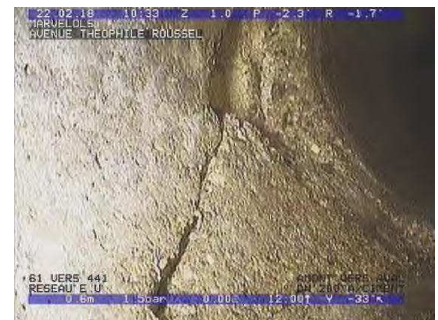
Fissure du collecteur
