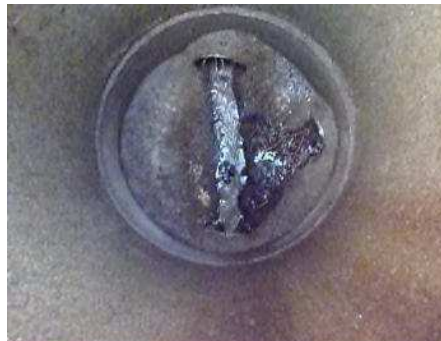
Intrusions jonction regard / canalisation RV n°440
