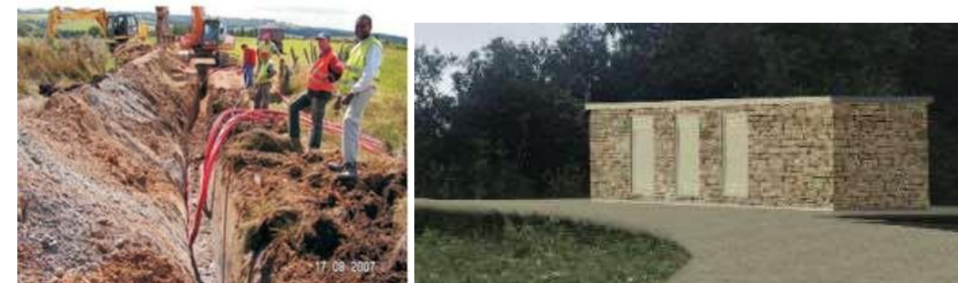
Photographie 7 : Déroutage et pose des câbles (à gauche), poste de livraison (à droite)
