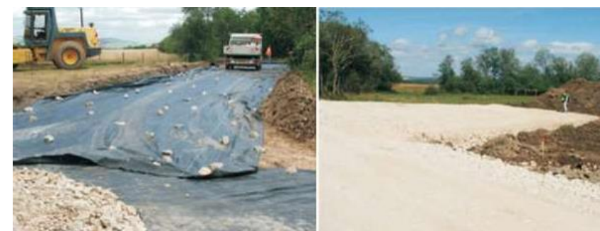
Photographie 5 : Pose d'un géotextile (à gauche), état final d'une plate-forme (à droite)
