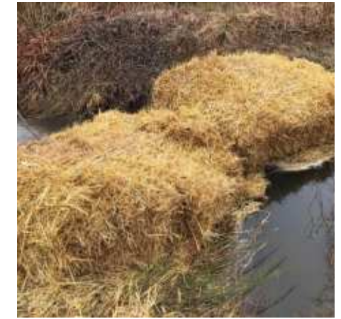
Figure 451: Bottes de paille appliquées en aval du franchissement en mesures préventives de MES
