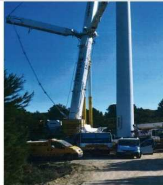
2 - Mise en place des engins de matutention (Grues, tracteurs et camions navettes) au pied de l'éolienne
